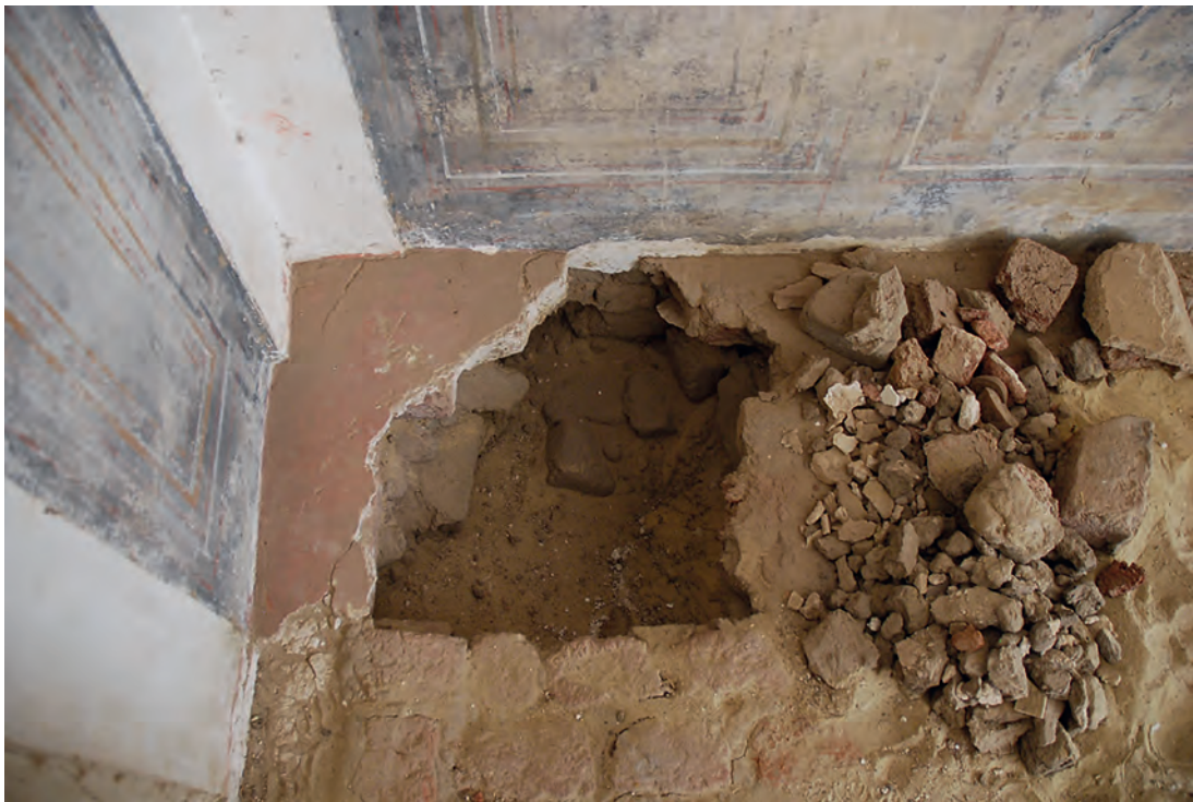
Abb. 14: Hauptraum, Ausbruch im Fußboden in Südwestecke; 2009
