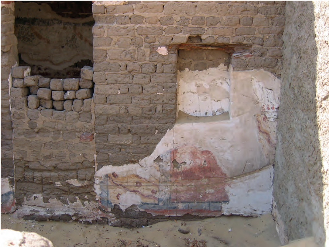
Abb. 22: Raum GB 5.2.1, Westwand mit Resten von Wandmalerei; 2006
