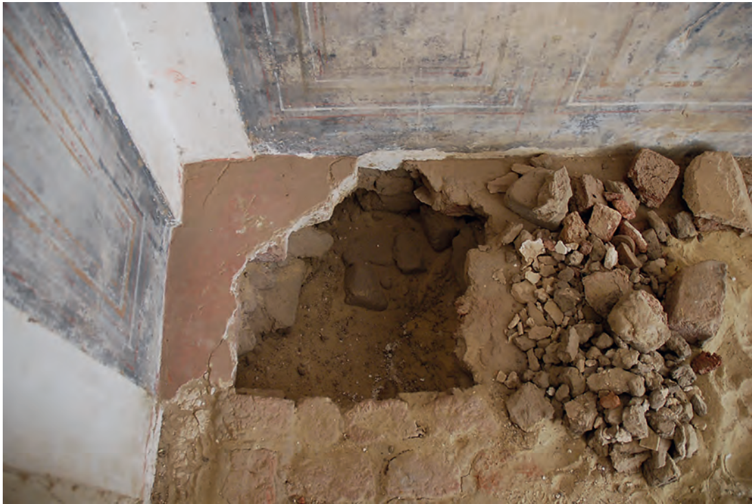
Abb. 14: Hauptraum, Ausbruch im Fußboden in Südwestecke; 2009
