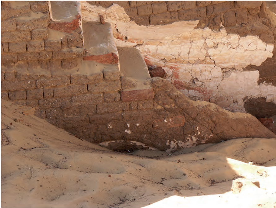
Abb. 14: GB 5, Straßentreppe. Treppenstufen aus gebrannten Ziegeln mit aufgesetzter Wange aus ungebrannten Ziegeln. Freigelegter Scheitel des nördlichen, tiefer gelegenen Substruktionsbogens mit Spuren von Lehmputz und Kalküberzug; 2006
