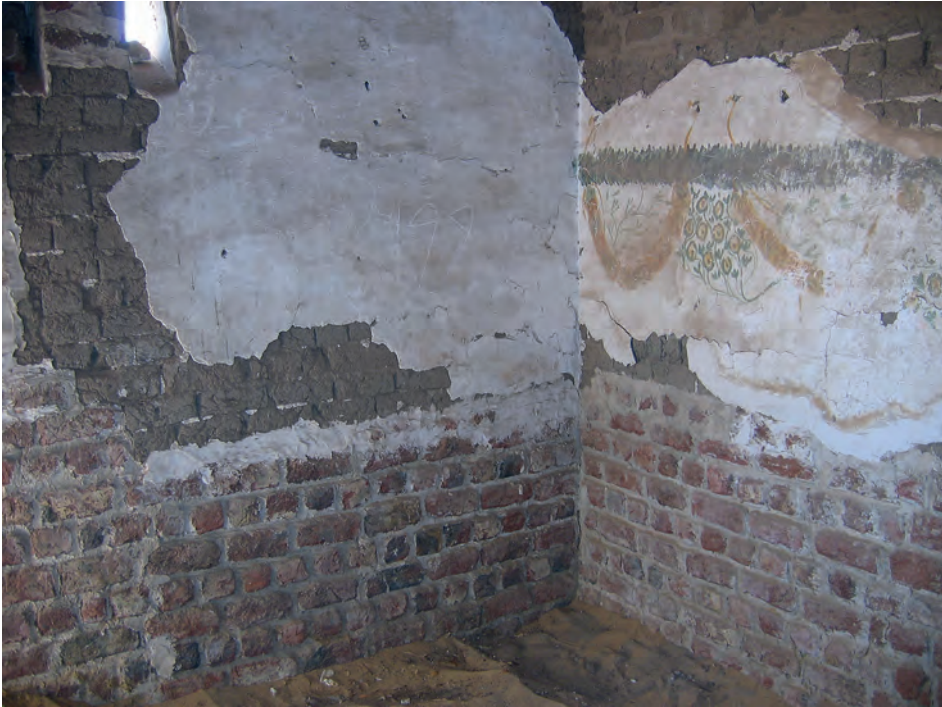
Abb. 28: Raum GB 5.2.2, Blick in die Südwestecke. Oben zu erkennen sind die Reste der originalen Wand mit Malerei, während die Wandsockel mit gebrannten Ziegeln ergänzt wurden; 2006
