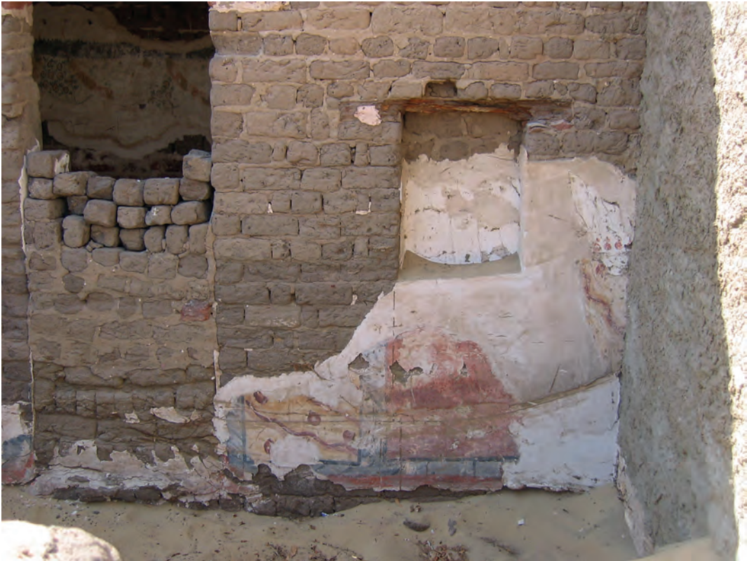
Abb. 22: Raum GB 5.2.1, Westwand mit Resten von Wandmalerei; 2006
