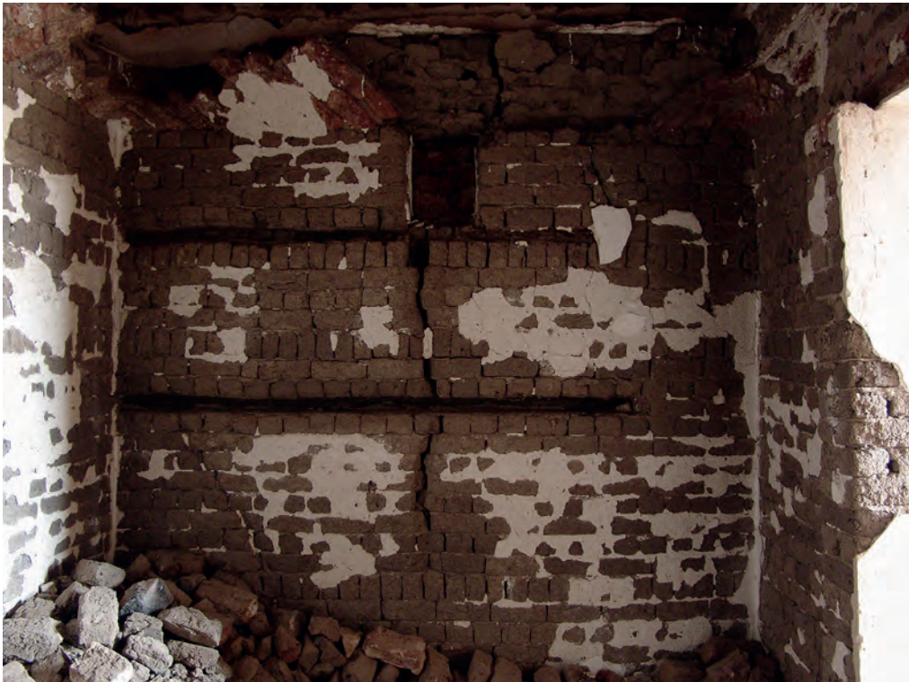
Abb. 26: Raum GB 7.2.3, Holzbewehrung in der Nordwand; 2006
