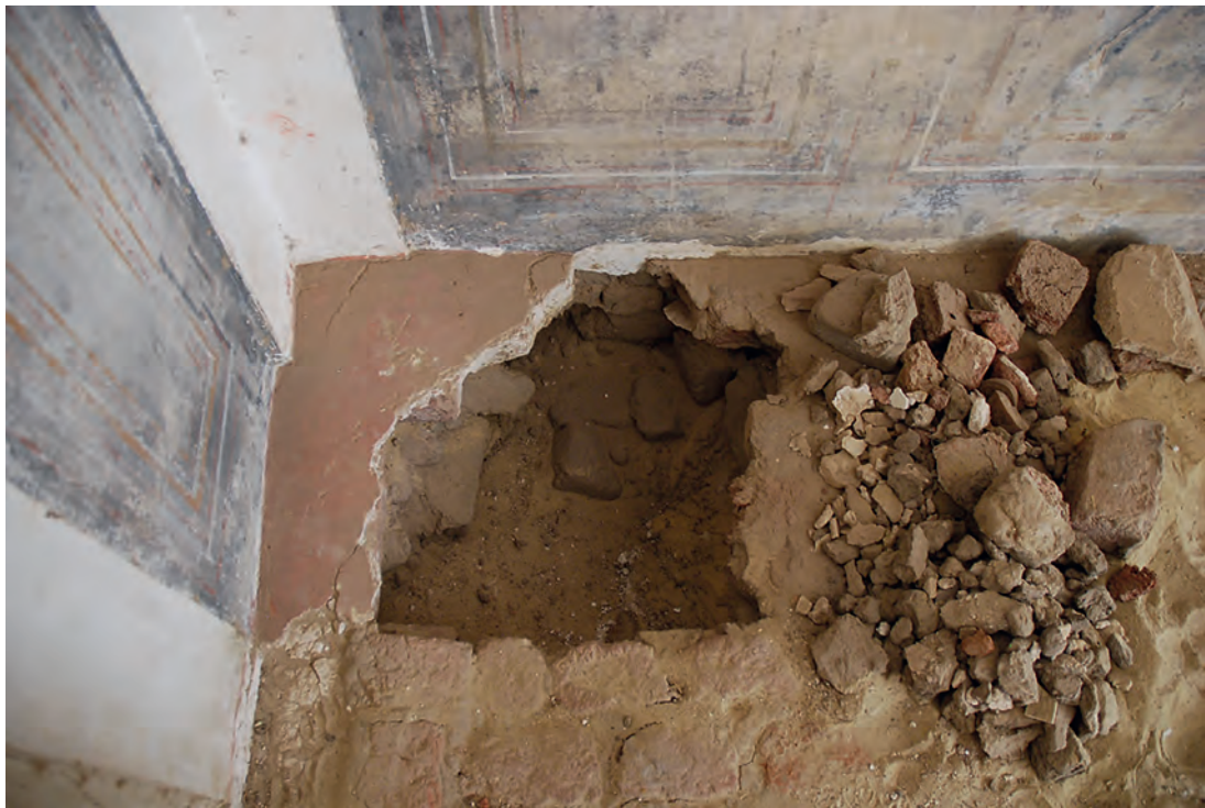
Abb. 14: Hauptraum, Ausbruch im Fußboden in Südwestecke; 2009
