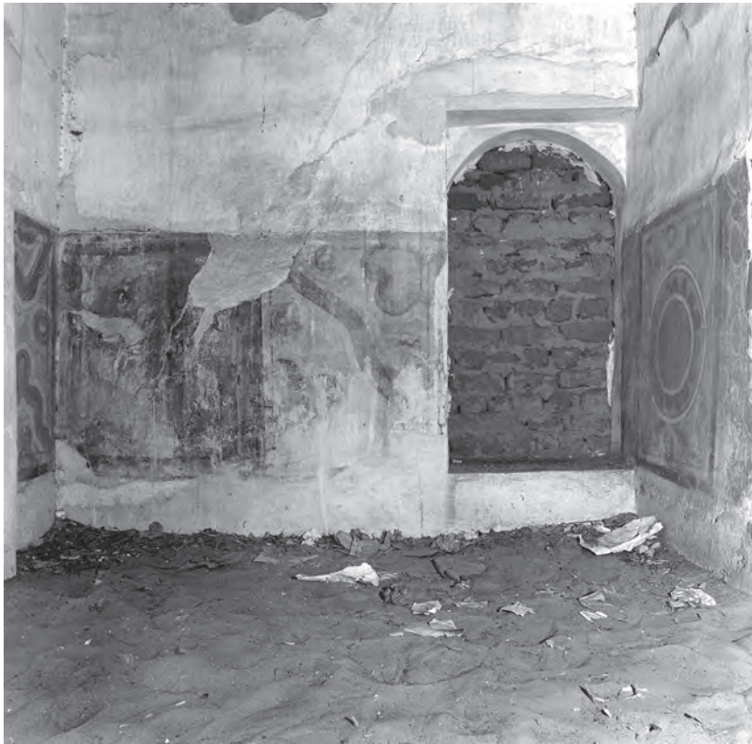
Abb. 24: Südseite von Raum GB 6.2.2; 1987
