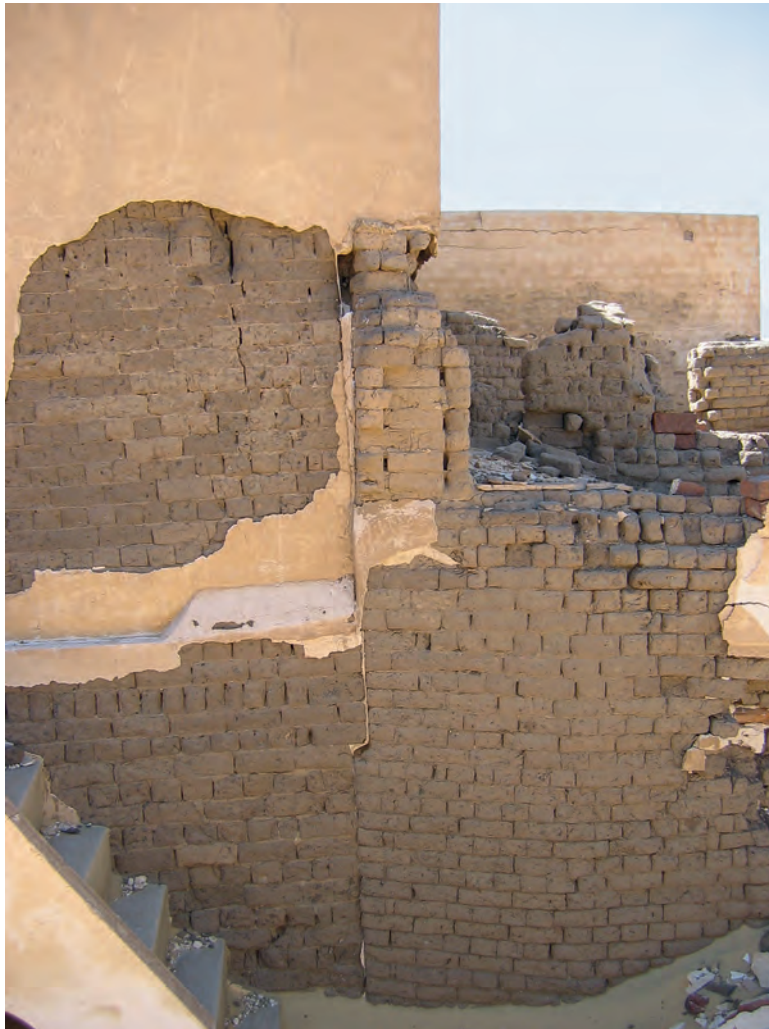
Abb. 12: Putzreste an der Nordwestecke im Unter- und Obergeschoss; 2005
