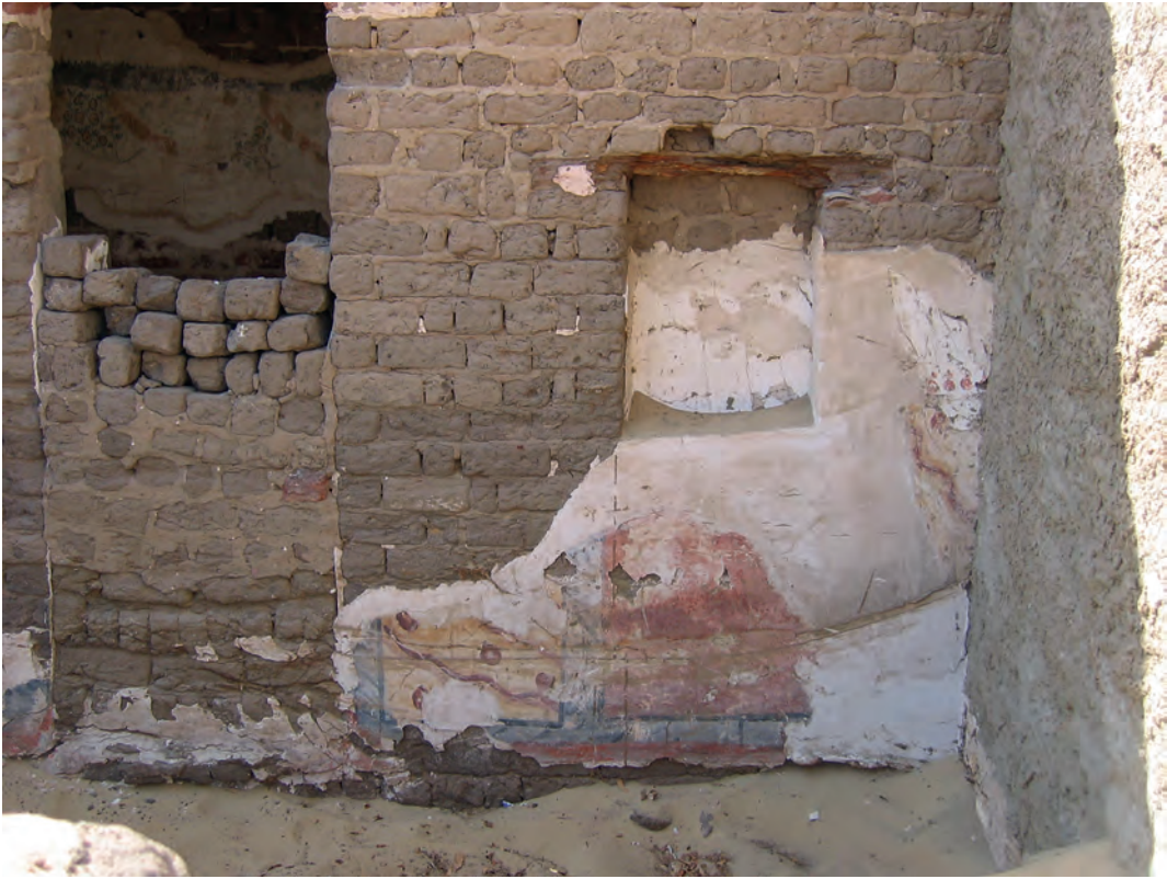
Abb. 22: Raum GB 5.2.1, Westwand mit Resten von Wandmalerei; 2006
