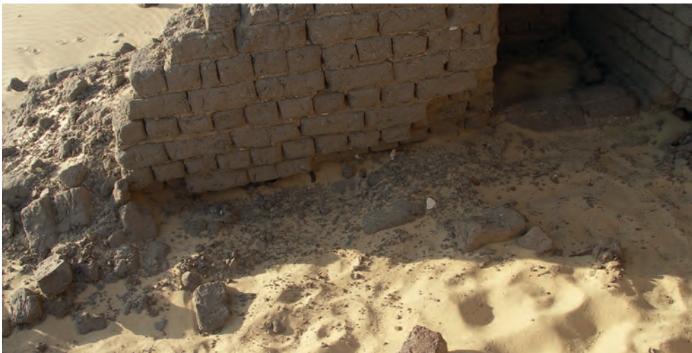
Abb. 11: GB 200.2.1, Südwand, horizontal verlaufende Fehlstelle am Wandfuß der Trennwand zwischen GB 200.2.1 und dem Treppenhaus mit dem Abdruck des verrotteten Holzunterzugs; 2010
